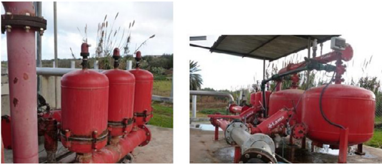
Figura 8: Batería de filtros a la salida del embalse (con autorización de O. Mahjoub, 2015)
