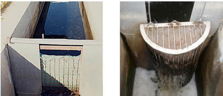
Figura 7: Malla colocada en la salida de la PTAR en Ouardanine en el 2003 (izquierda), y tamiz y malla colocados en el 2004 (derecha) (con autorización de O. Mahjoub, 2003, 2015)
