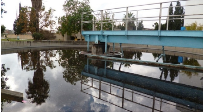
Figura 3: Clarificador secundario en la PTAR de Ouardanine (con autorización de O. Mahjoub, 2015)
