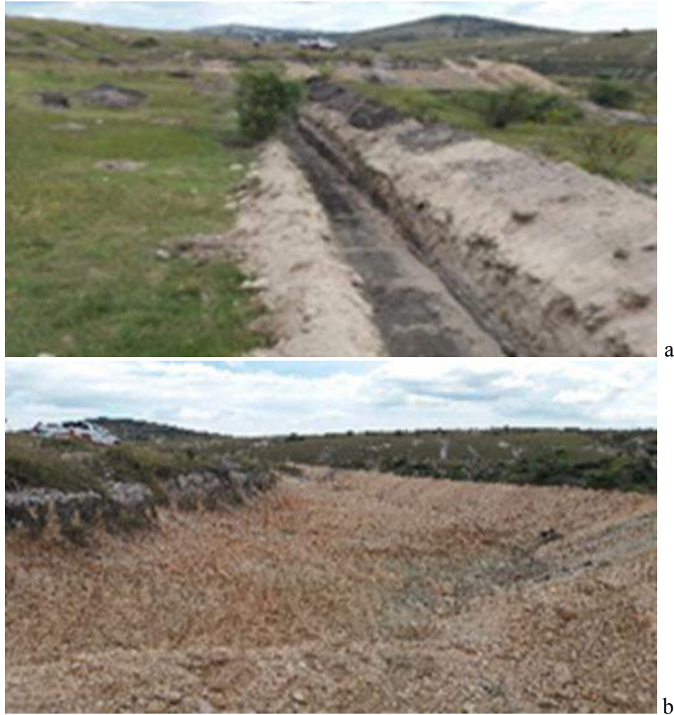
Figura 4. Zanja trinchera III (a). La mayor zanja construida en el Sector de Referencia localizado en el Ecocampus BUAP en Valsequillo, contribuirá al llenado del Jagüey (b).
